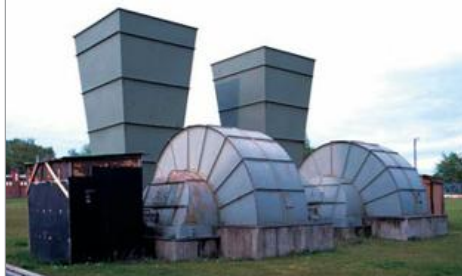
Die Anlagen mit den Ventilatoren für die Bewetterung eines Schachtes sind heute nicht sehr groß.
