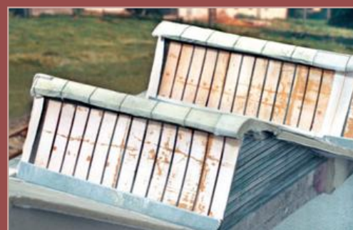
Da auf die Transparentfolie verzichtet wurde, erkennt man deutlich die Fensterverschmutzungen.
