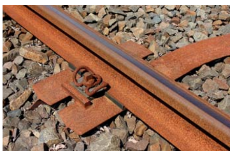
Gut zu erkennen sind die angeschweißte Schienenbefestigung und die Spannklemme.
