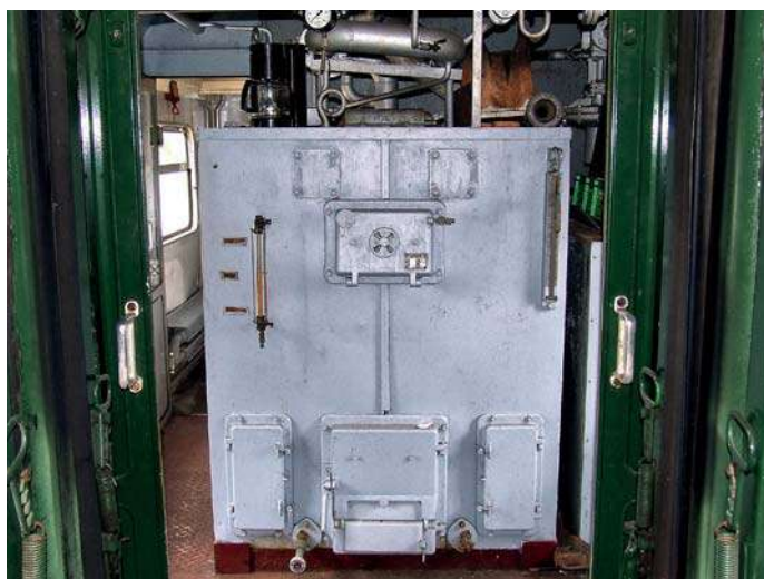
Ein großer Niederdruckkessel sorgt für den zum Kochen notwendigen Dampf.
