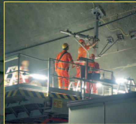
Die Fahrleitung ist an 1500 Tragwerken aufgehängt, die künftig gewartet werden müssen.
