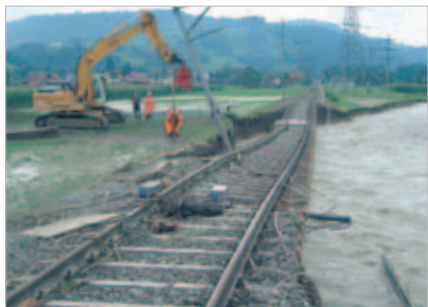
Die Emme unterspülte das Bahngleis bei Schachen-Malters zwischen Luzern und Wolhusen.
