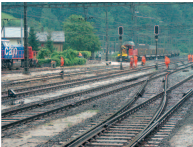
SBB-Aufräumannschaften beseitigen in Ziegelbrücke die Schäden eines Erdbeutes, um wenigstens einen Minimalbetrieb zu gewährleisten.
