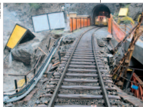
Die alte Tasna-Brücke der RhB zwischen Ardez und Scuol wurde weggespült. Parallel entsteht zum Glück eine neue Brücke.
