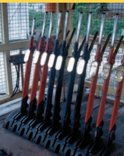
An der Nordausfahrt des Bahnhofs Tappa begnügt man sich mit der Unterbringung der Hebelbank in einer einfachen Gitterbox.
