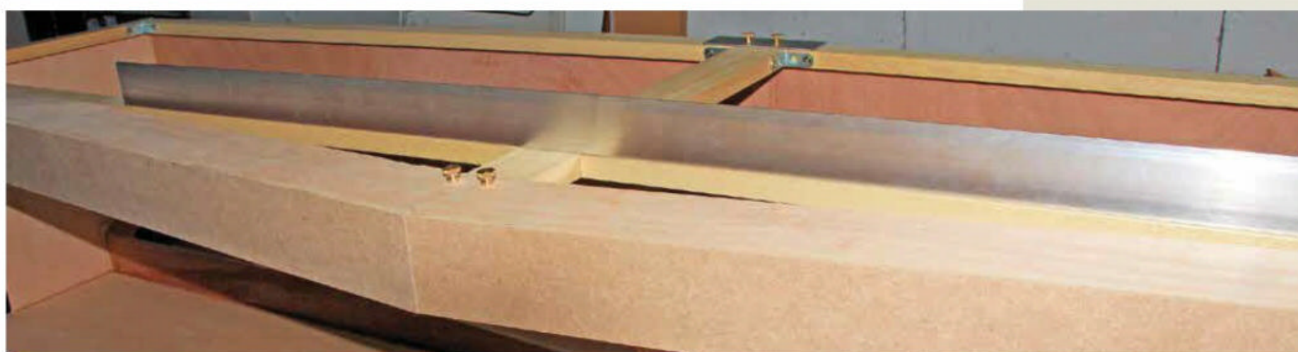
11 - Partie supérieure du réseau. On remarque les blocs d'éclairage au premier plan et la cornière aluminium de blocage entre les deux « ciels » au second plan.
