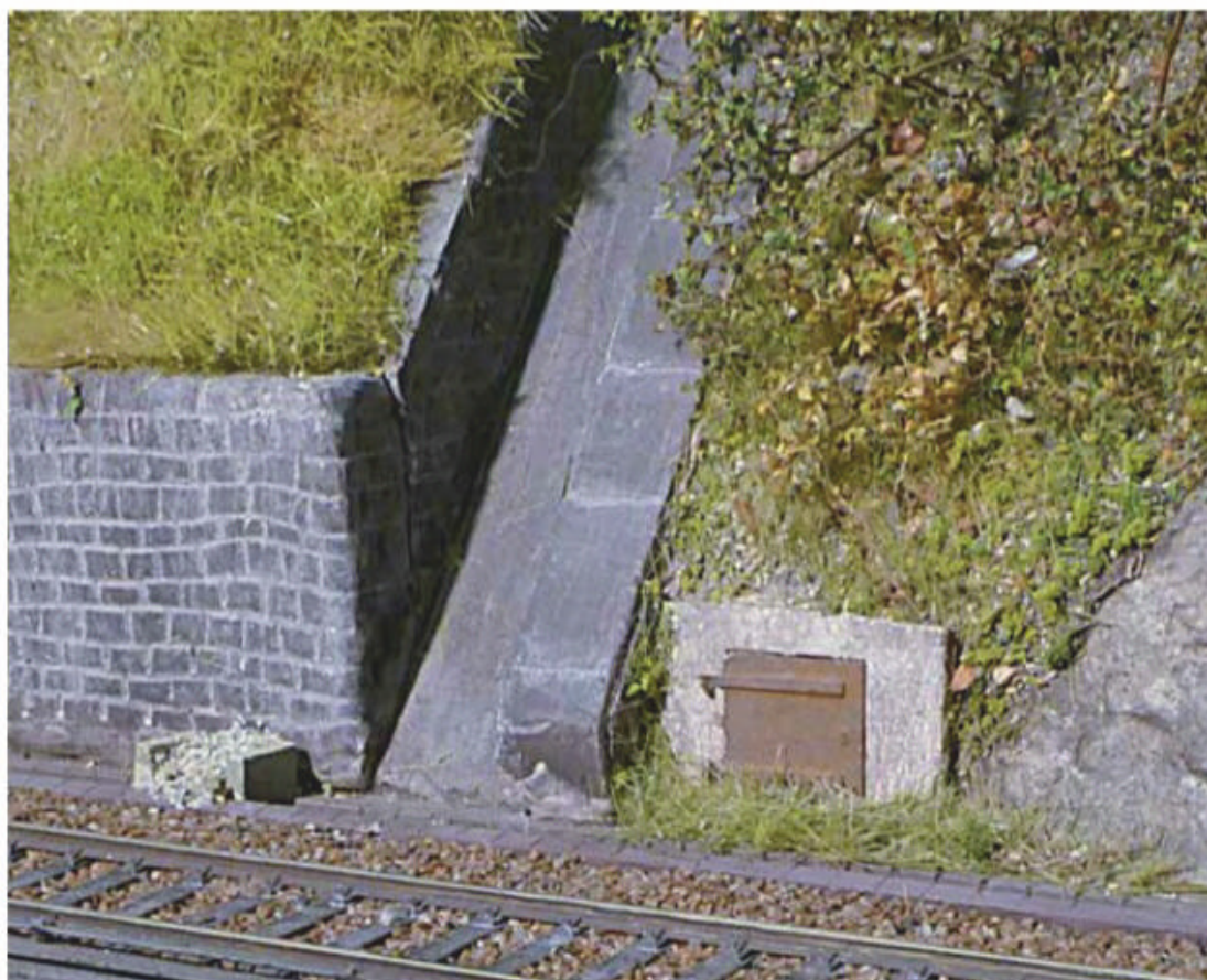
10 Quelques détails typiques de la ligne : une porte rouillée dissimule un captage ; à sa gauche, un écoulement à l'air libre aboutit dans le caniveau longeant la voie. Le gravier destiné au soufflage mesuré est normalement situé dans l'entrevoie. La présence de l'alimentation par troisième rail impose de le placer de part et d'autre des voies.
