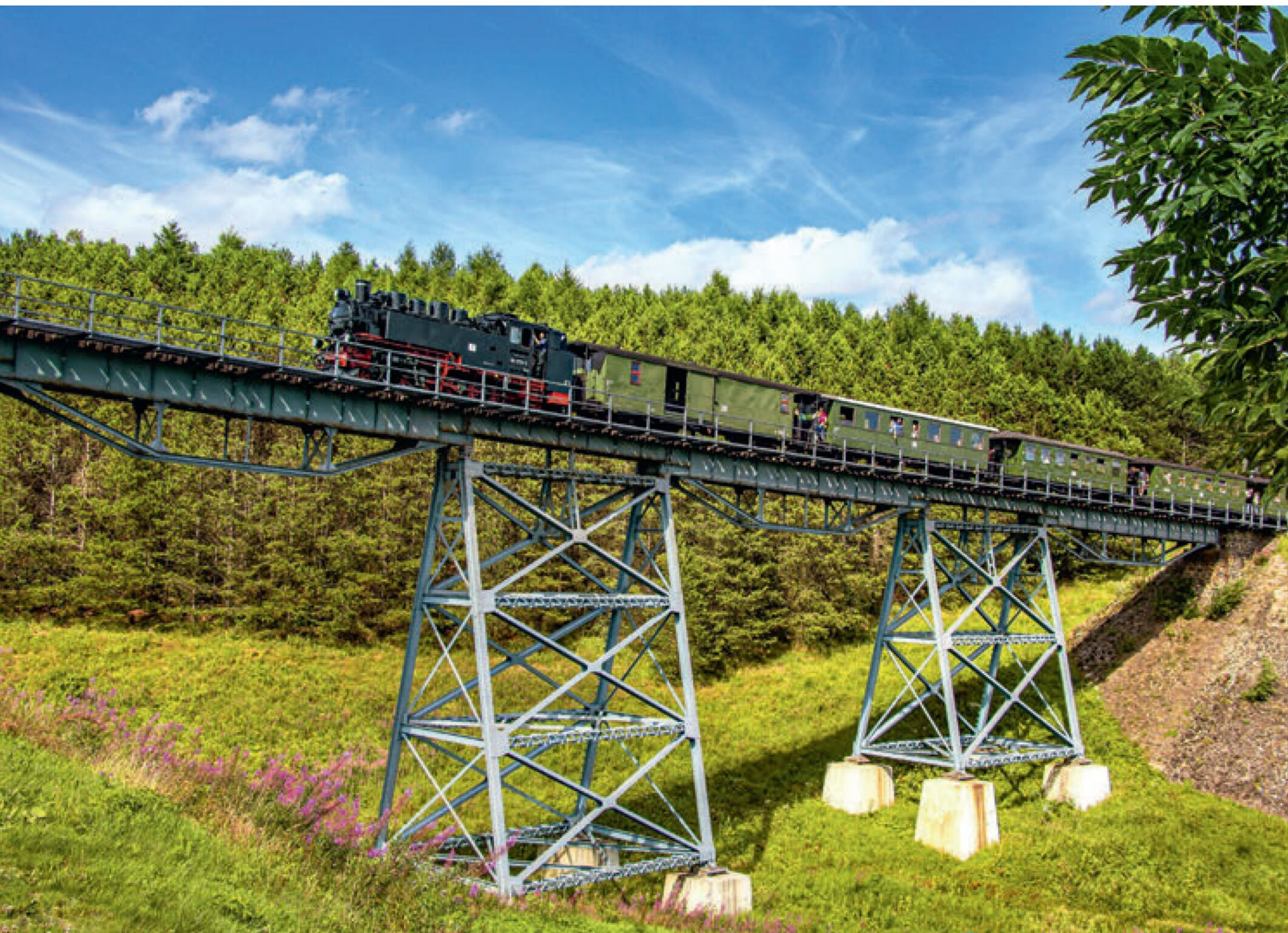
Kulturdenkmal der Fichtelbergbahn: Der Hüttenbachtal-Viadukt hat eine Gesamtlänge von 110 Metern und eine Höhe von 23 Metern und liegt kurz vor Oberwiesenthal. Dort angekommen, kann man mit der Schwebebahn bis hinauf zum Gipfel des Fichtelbergs fahren.
