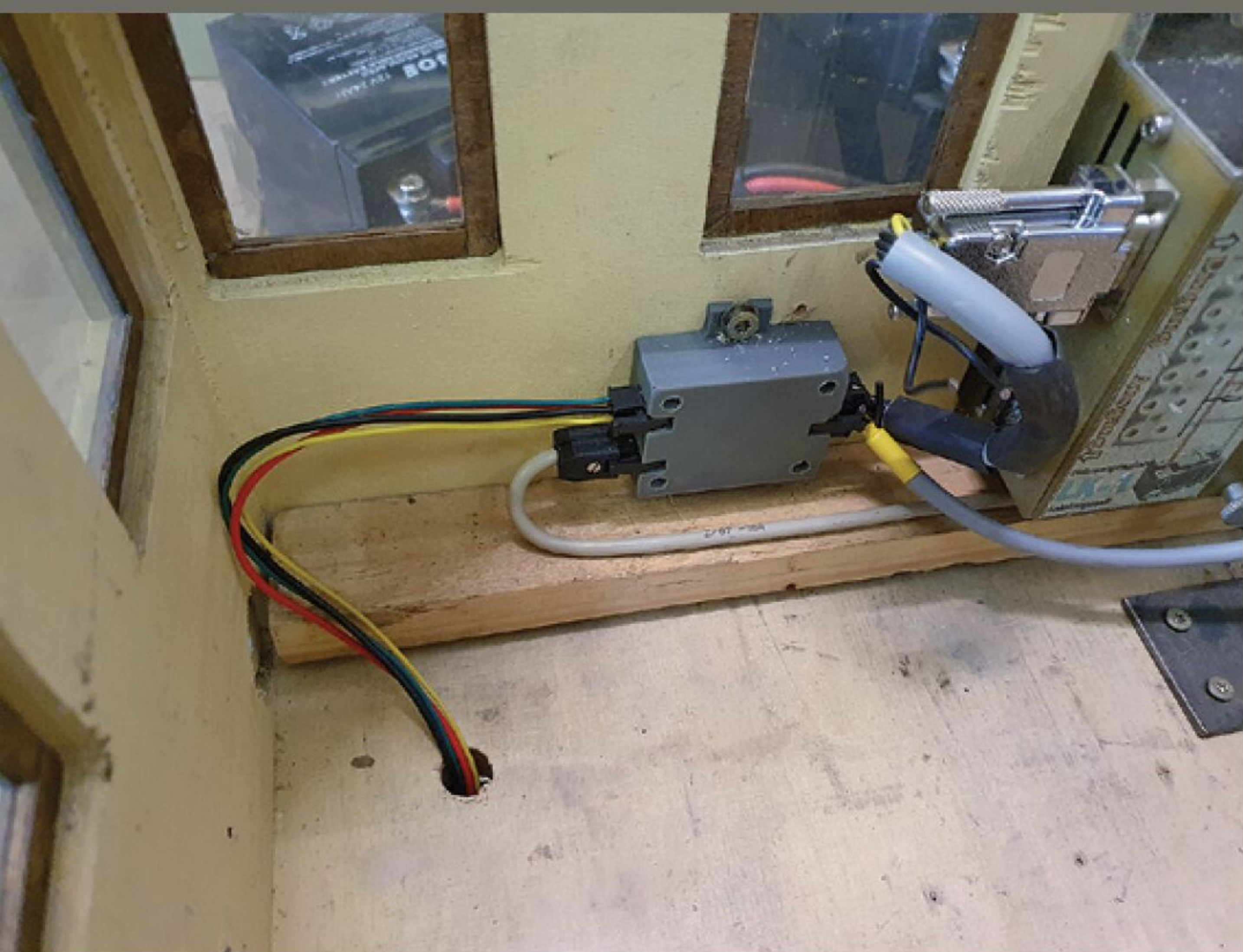
Das Motor-Modul neben der LK1-Endstufe. Das Kabel links läuft zum Steuerstecker am Fahrzeugrahmen.
