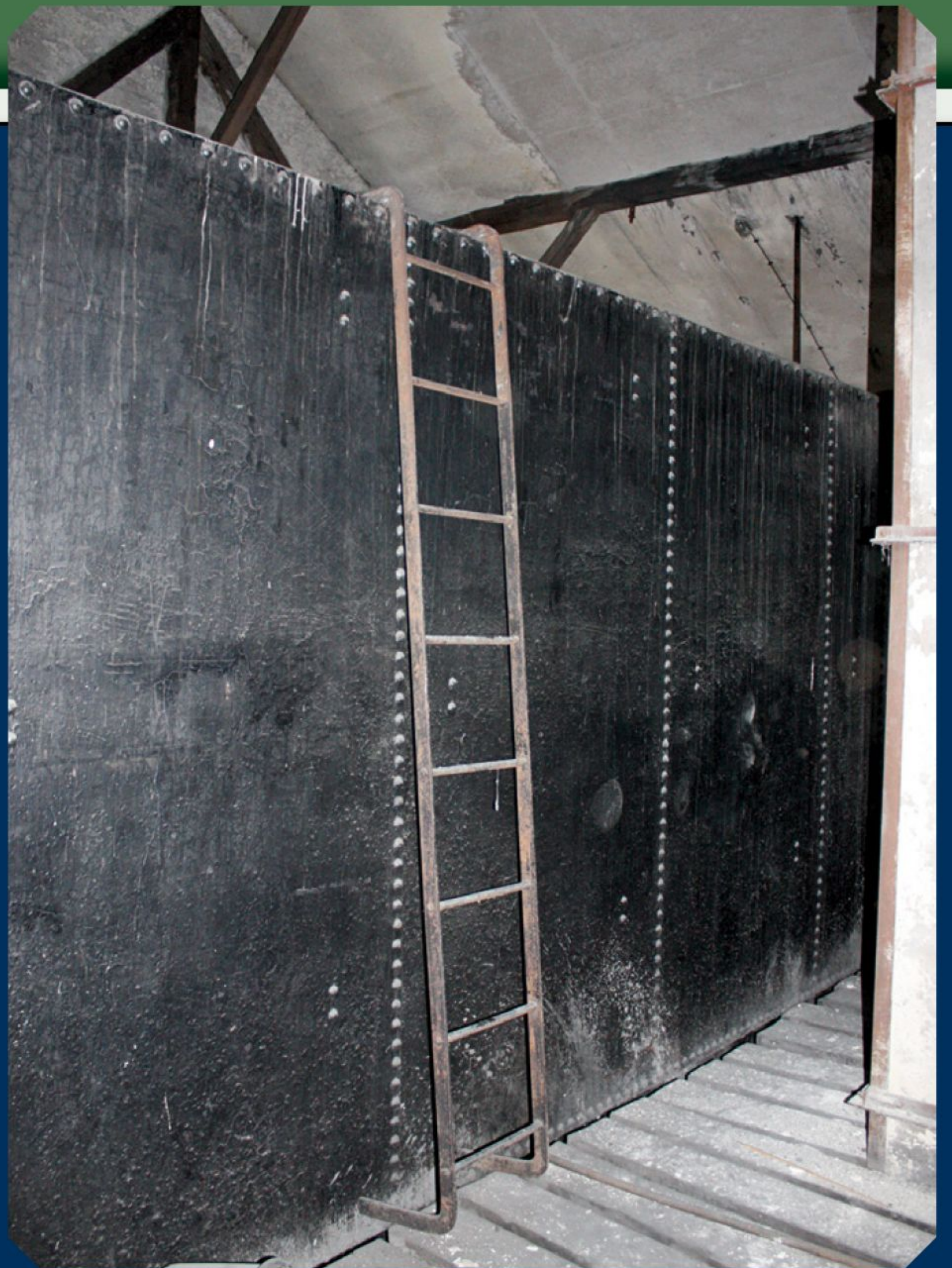
Nicht UNESCO-Welterbe, aber dennoch sehens- und erhaltenswert: Die drei Zisternen im ehem. „Wasserhaus“ hatten ein Fassungsvermögen von rund 250.000 Litern. Die 250 Tonnen und ca. 15 Tonnen des Stahls samt Nieten erforderten auch stabile Tragmauern, die im Kellerbereich ca. 70 cm stark sind. (Foto: S. Baum)
