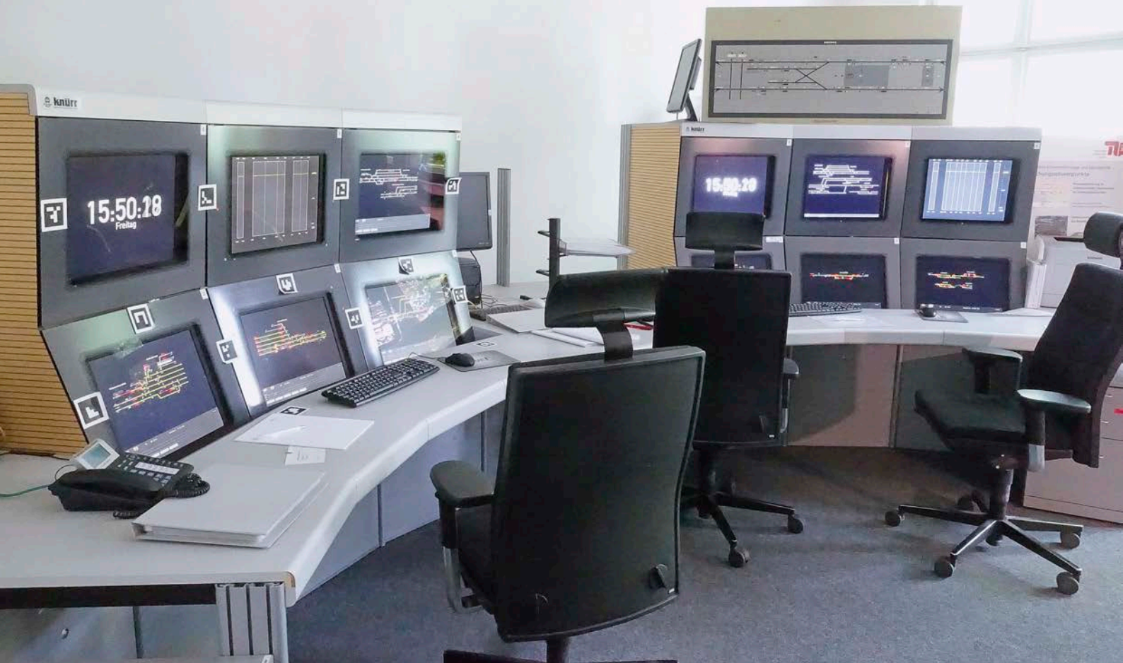
Blick in die Betriebszentrale des Eisenbahn-Experimentierfeldes der TU Berlin: Die ESTW-Software ist eine Eigenentwicklung und benötigt spezielle Server-Hardware. Die Kommunikation mit der Modellbahnanlage erfolgt über LocoNet-over-TCP
