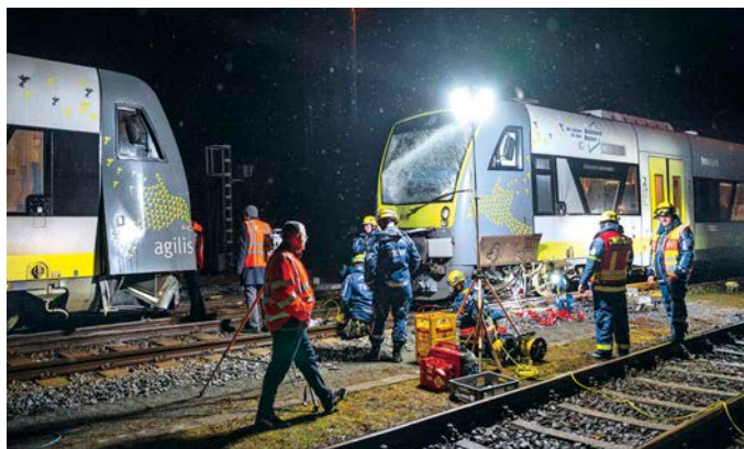
Einsatzkräfte des THW und der Agilis Verkehrsgesellschaft bei den Bergungsarbeiten der beiden kollidierten RS 1 in Bayreuth picture alliance/dpa/Daniel Vogl
