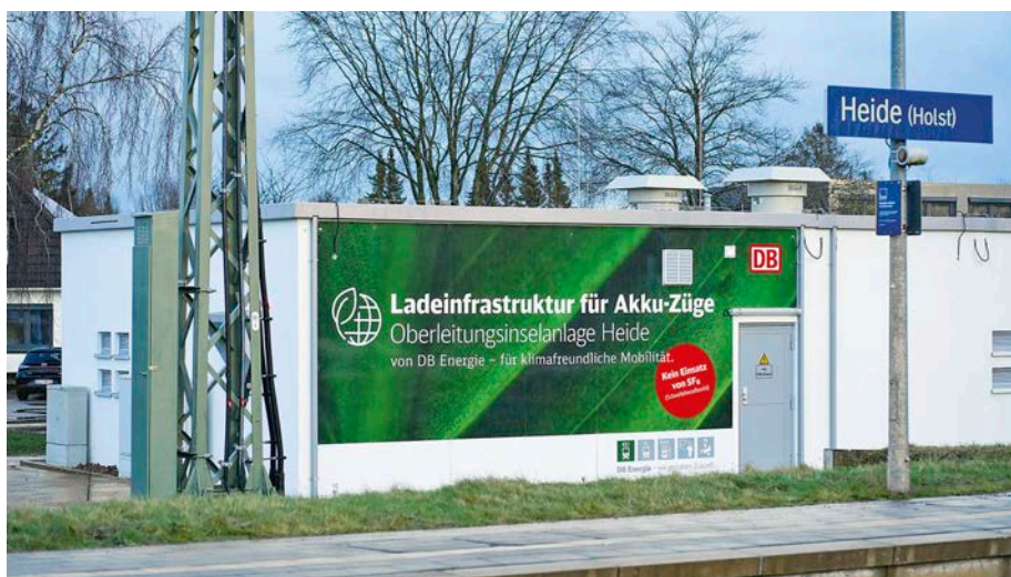
Schlüsselfertiges Unterwerk von Rail Power Systems in Heide: In den kompakten Gebäudekörpern stecken Umrichter, Transformatoren und Mittelspannungsanlagen. Hier sind auch Telekommunikation, Netzüberwachung und Schutztechnik integriert
