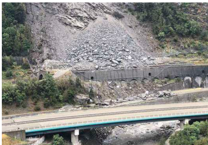
Ein Erdbeben hatte im August 2023 die Bahnstrecke im Maurienne-Tal verschüttet, die Wiederherstellung dauerte länger als erwartet
