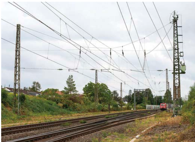
Erstes Tragwerk des Bahnhofes Roisdorf aus Richtung Bonn mit zusätzlich angebrachtem Masttrafo und Schalter am rechten Quertragwerksmast. Die Fahrleitungsführung vor allem über der Weiche ist gut nachvollziehbar
