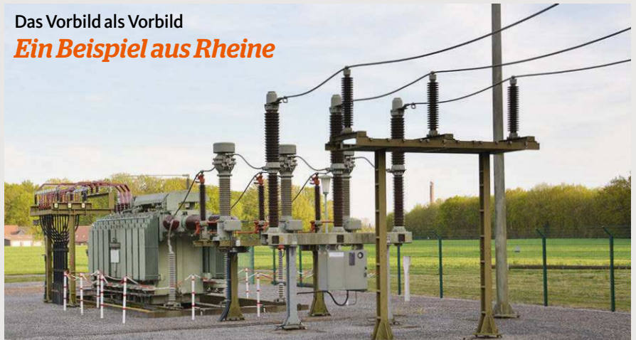
Kleines Umspannwerk für 110/30 Kilovolt mit zwei Trafos (nur einer im Bild); die rechts von den nicht abgebildeten Leitungstrennschaltern ankommende dreiphasige 110-kV-Leitung geht weiter zu den Leistungsschaltern und von dort in den Transformator
