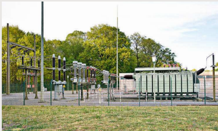
Leitungsabspannung der ankommenden 110-kV-Hochspannungsleitung; beim umgesetzten Modell auf diesen Seiten könnte man diese Abspannung an den Portalen nachrüsten
