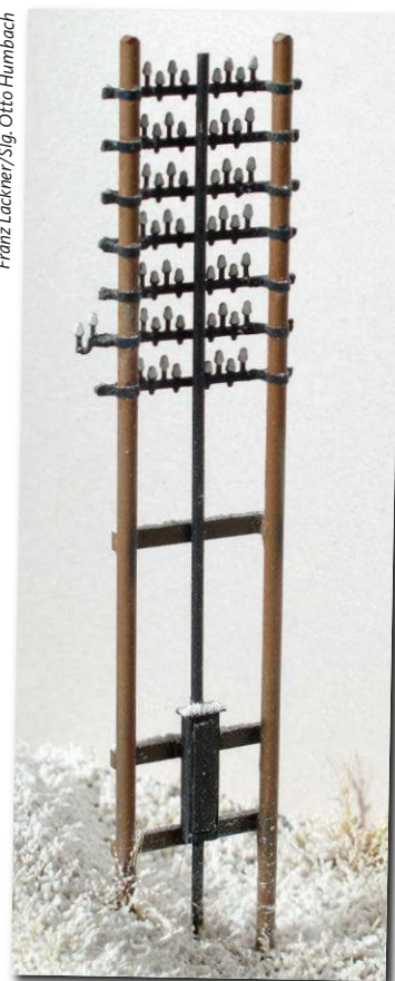
Beispiel eines Doppelmastes mit sieben Quertragwerken und einer Ableitung zur Weiterführung der Freileitung im Boden
