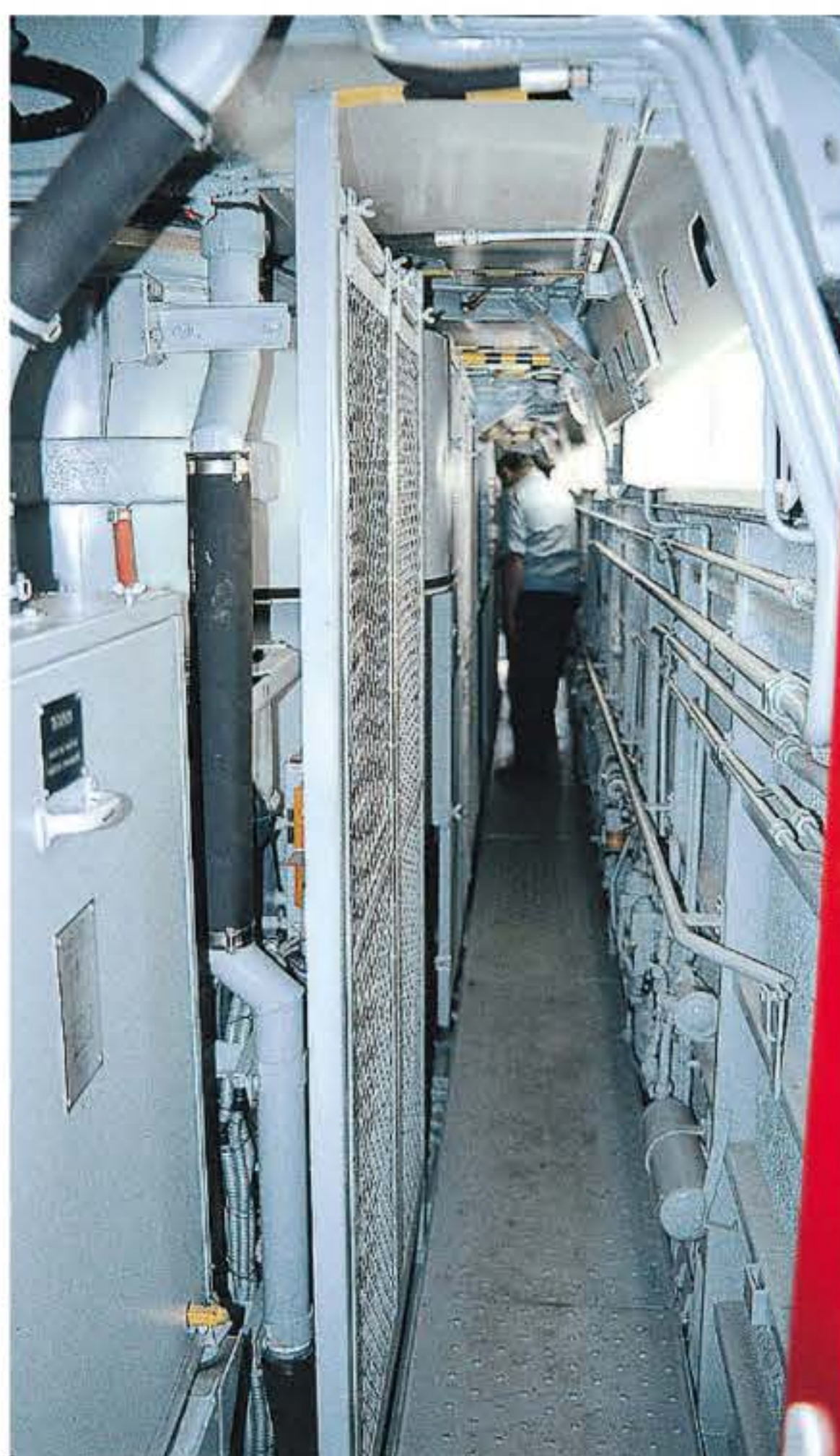
Seitengang im Maschinenraum der 252, im Dachbereich liegen die Kühlflüssigkeitschächte
