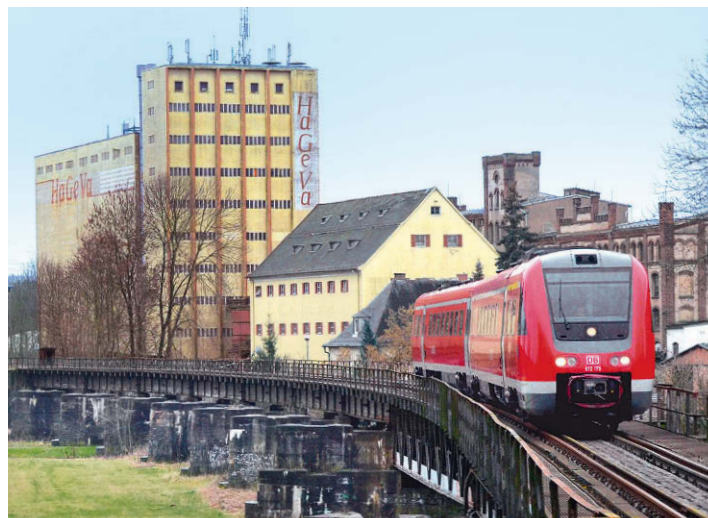
Die baufällige Liebschwitzer Elsterbrücke ist derzeit die „Achillesferse“ der gesamten Elstertalbahn. Geht es nach DB-Netz, werden hier schon ab Dezember keine Züge mehr fahren
