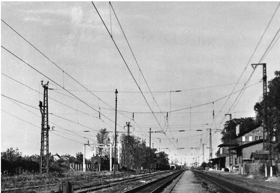
Das im Bf Jeßnitz aufgestellte fahrbare Unterwerk speiste interimweise bis zur Inbetriebnahme des Schaltpostens Bitterfeld die Strecke Roßlau – Dessau – Bitterfeld (– Leipzig).
