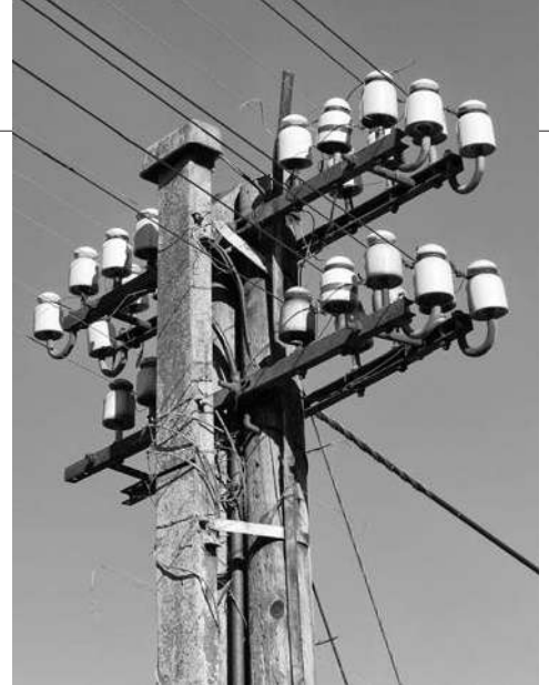
Telegrafeneleitungs-Detail im Ahrtal.
