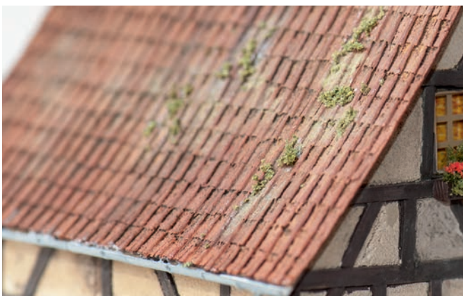
Auf alten Dächern häufig: Moosbewuchs, hier durch N-Laub
