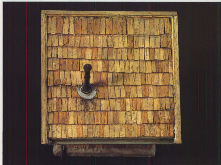
Bild 45: Das fertige Dach aus der Vogelperspektive. Unterschiedliche Form und Farbe der Schindeln erzeugen eine frappierende Lebendigkeit. Eine künstliche Alterung ist nicht mehr erforderlich.
