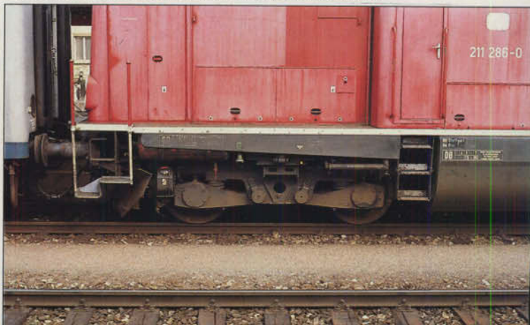
Bild 4: Der untere Bereich der V 100 mit dem Drehgestell ist durch deutliche Spuren von Bremsstaub, Schmutz und Öl gekennzeichnet.
