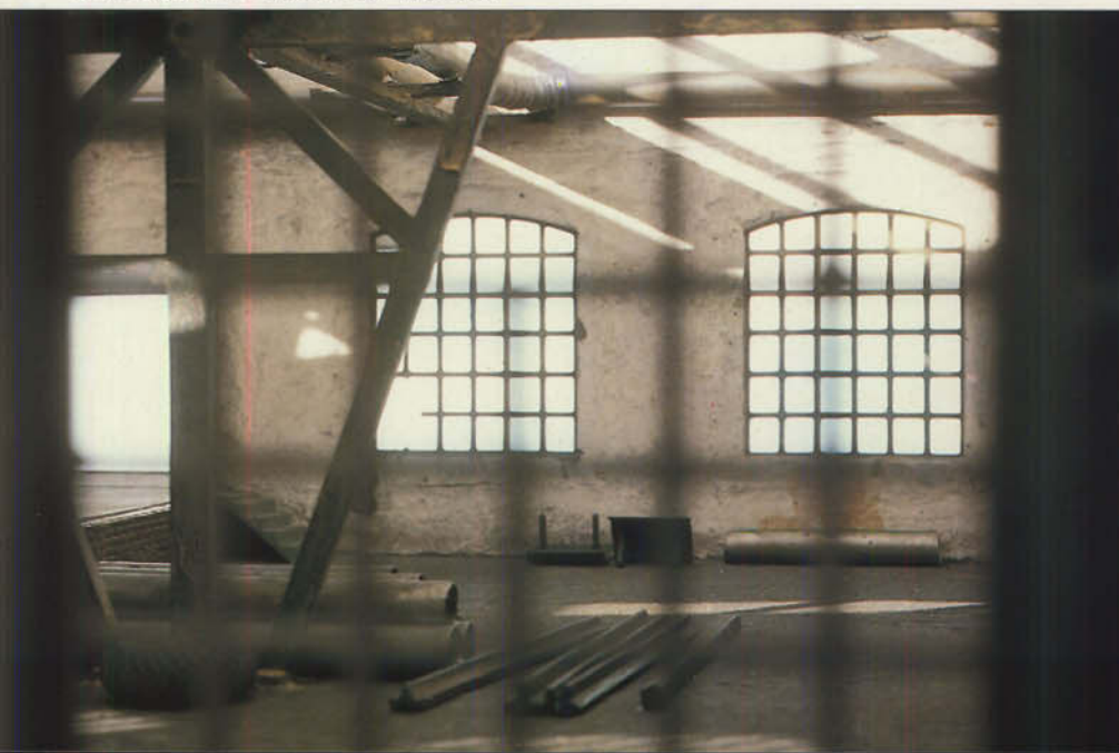
Bild 21: Schräg einfallende Sonnenstrahlen zeigen das triste Aussehen des Halleninnern. Nur einige Rohre und Profile "zieren" den Fußboden.
