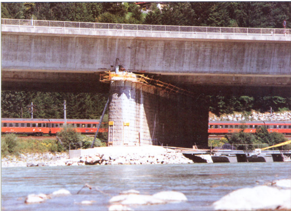
Der abgesackte Pfeiler der Autobahnbrücke über den Inn bei Kufstein wird saniert und später gehoben. Unterdessen rollt der Verkehr auf der nahen Eisenbahnstrecke Richtung Brenner wieder reibungslos. Foto: R. Rossberg
