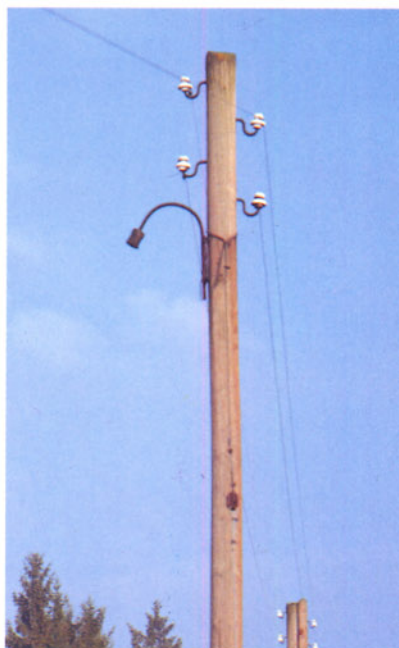
Bild 4 (unten links): Die fertige Lampe, installiert an einem einfachen Telegrafeneinzelmast, der ebenfalls im Eigenbau entstand.
