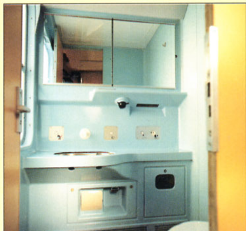
Bild 24: Der Waschtisch im WC des Bim 263. Werkfoto PFA
