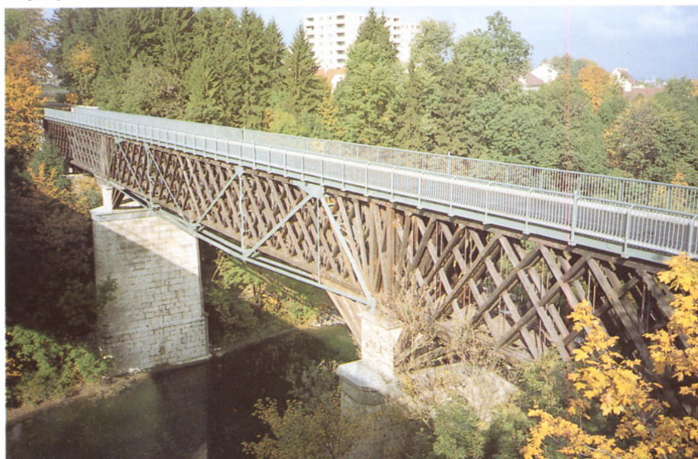
Bild 5: Blick auf die Holzbrücke mit dem untergehängten Stahlzugband, das nachträglich zur Verstärkung angebracht worden war und das man auch nach der Rekonstruktion beibehalten hat.
