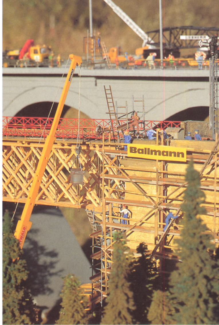
Bild 9: Auch das rechte Widerlager besitzt ein Baugerüst. Auf dieser Seite sind die Bauarbeiter noch voll bei der Sache. Mit einem Teleskop-Kranwagen wird gerade ein schweres Ausrüstungsteil auf die Brücke gehoben.
