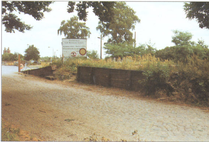
Bild 14: Dieses (verwahrloste) Bild bietet das Vorbild von der Straßenseite aus. Deutlich ist die Bohlenverstärkung zu sehen.
