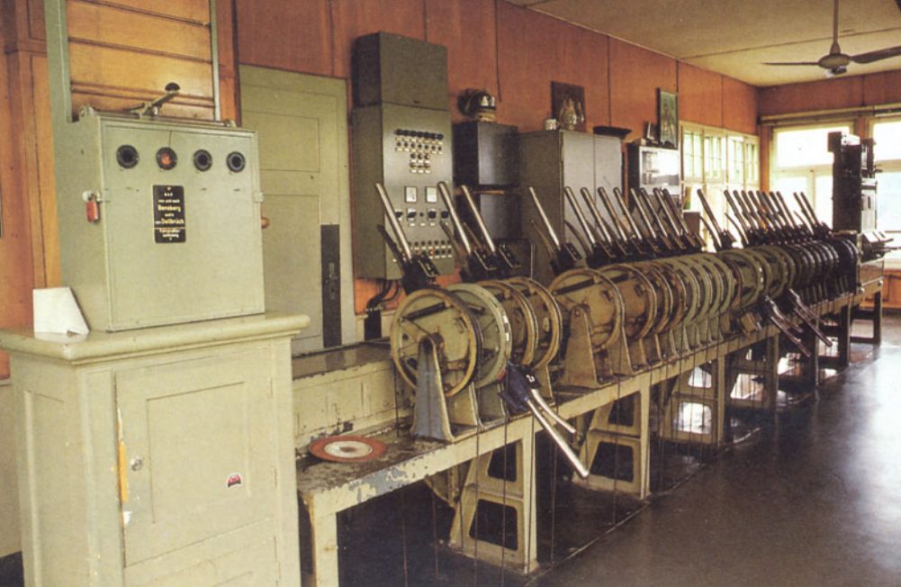
Bild 6: Der Bedienungsraum mit Blick auf die Hebelbank.
