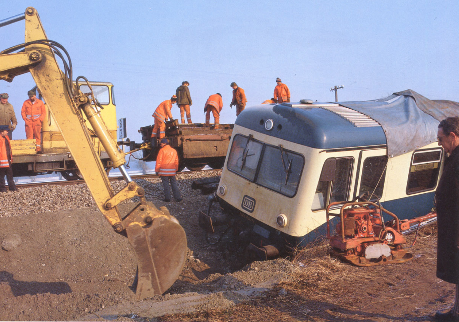
Bild 1: Am 05.03.1987 kollidierte ein LKW an einem Bahnübergang bei Karlskron (Strecke Augsburg – Ingolstadt) mit dem Dieseltriebzug 628 102/928 102. Der Dieseltriebzug ist dabei aus den Schienen gesprungen. Sechs Tage später ist man nun dabei, den Bahndamm an der Unfallstelle zu verbreitern, damit die Seitenstützen der Schienenkräne, die den Triebzug wieder auf das Gleis stellen sollen, guten Halt finden können.
