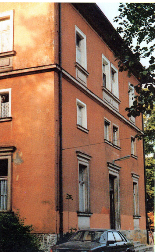
Bild 2: Das Stationsgebäude in Vorra (Strecke Nürnberg-Schnabelwaid), Vorbild für unseren "Würfel", hier von der Straßenseite her aufgenommen. Verputzt und Farbe sind spätere Zutaten. Der Fensterzierat ist original und typisch. Auch die Fenster selbst dürften noch aus der Zeit des Baues stammen.
