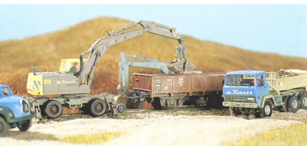
Bild 13: Bald ist Feierabend auf der Baustelle. Zug und Zweiwegebagger werden dann das Gleis räumen.
