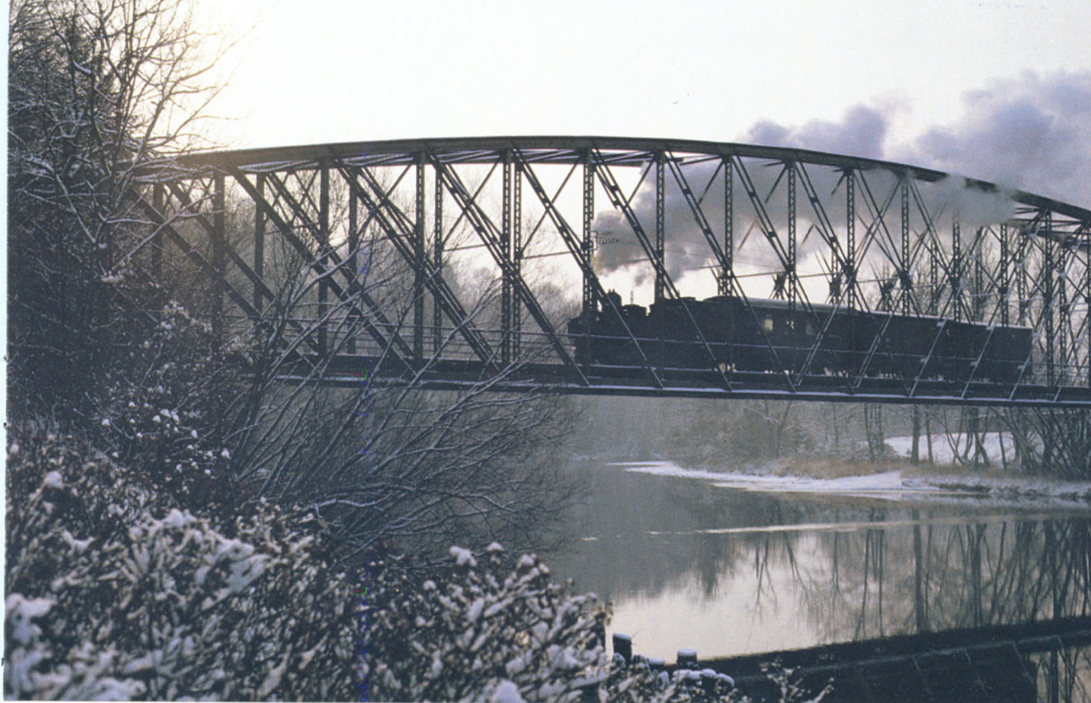
Bild 1: Die 298.52 führte am 31.12.1984 erstmals seit zweieinhalb Jahren wieder einen Zug auf der Steyrtalbahn. Der Arbeitszug der ÖGEG überquert bei Waldneukirchen soeben die Steyr. Foto: H. Krumphuber
