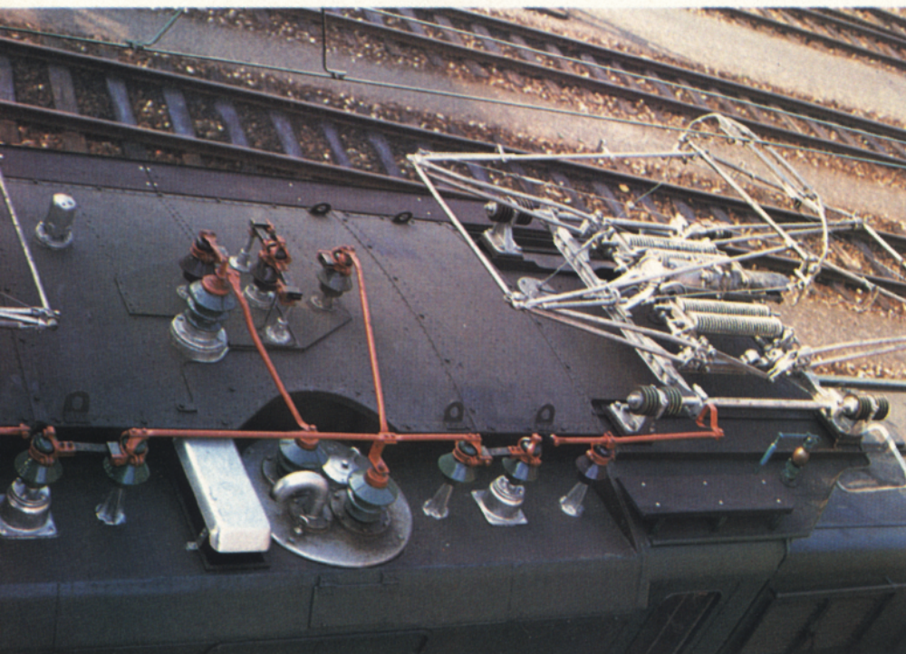
Bild 8: Diese Detailansicht der Vorbildlok zeigt die Anordnung der Leitungen und Isolatoren auf dem Dach des Wagenkastens. Foto: W. Kügler
