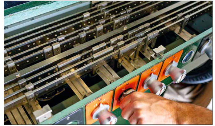
Bei elektromechanischen Stellwerken erfolgt die Fahrstraßensicherung mechanisch, auch hier beim EM55-Stellwerk in der Garage.
