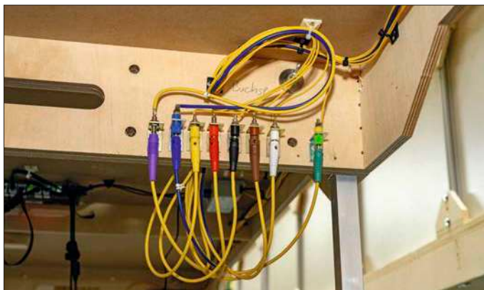
Die elektrische Verbindung der Segmente der Schweden-Anlage erfolgt mit farbcodierten Bündelsteckern.
