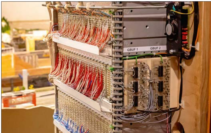
Die Schaltkarten der Gahler + Ringstmeier-Steuerung sind in 19-Zoll-Schaltschränken untergebracht.
