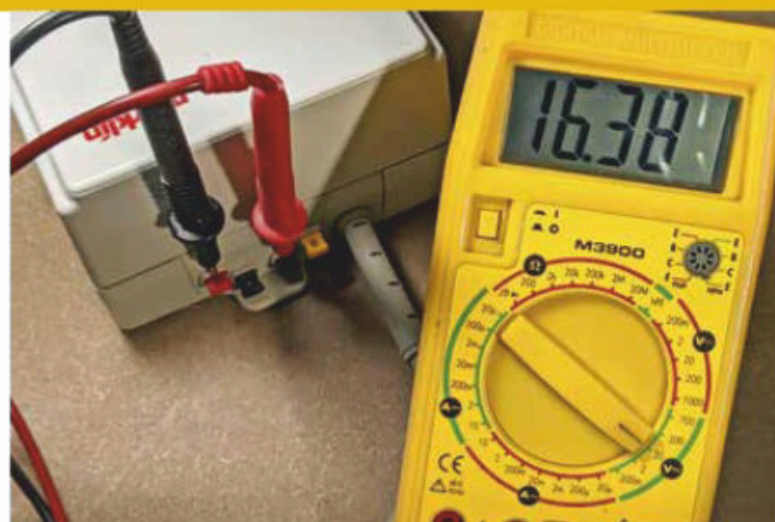
Photo 3. Contrôle de la tension alternative de sortie d'un transformateur-régulateur : la valeur est, comme indiquée par le fabricant, de 16 V environ.
