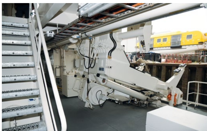
In den seitlichen Nischen stehen die hydraulischen Davits für die Kontrollboote
