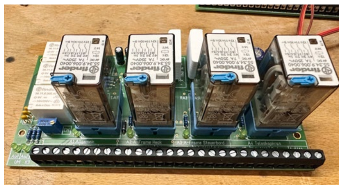
Auf der oberen Platine sitzen die Fahrregler und die großen Relais zur Ansteuerung und Umschaltung der vier Hauptfunktionsbaugruppen (1 = Allgemein, 2 = A-Frame Heck, 3 = A-Frame Steuerbord, 4 = Teleskopkran)
