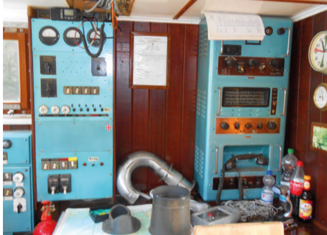
Schaltschrank mit Anzeigen und Sicherungen
