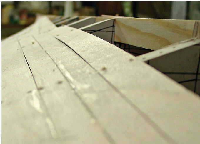
Hier muss noch nachgearbeitet werden
