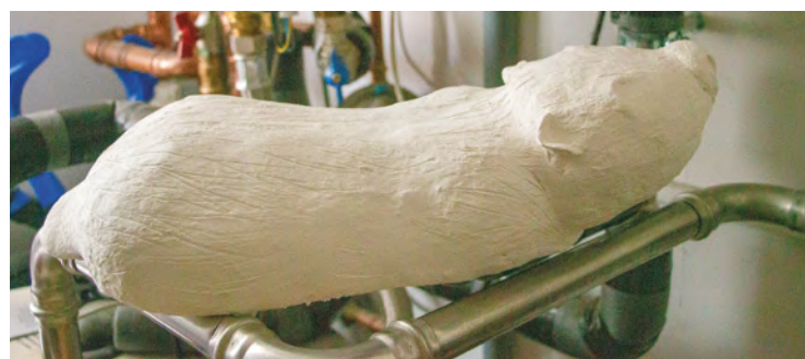
Trockenphase im Heizungsraum
