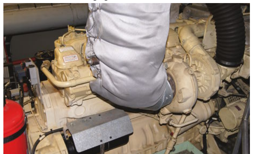
Der Hilfsdiesel zur Stromerzeugung
