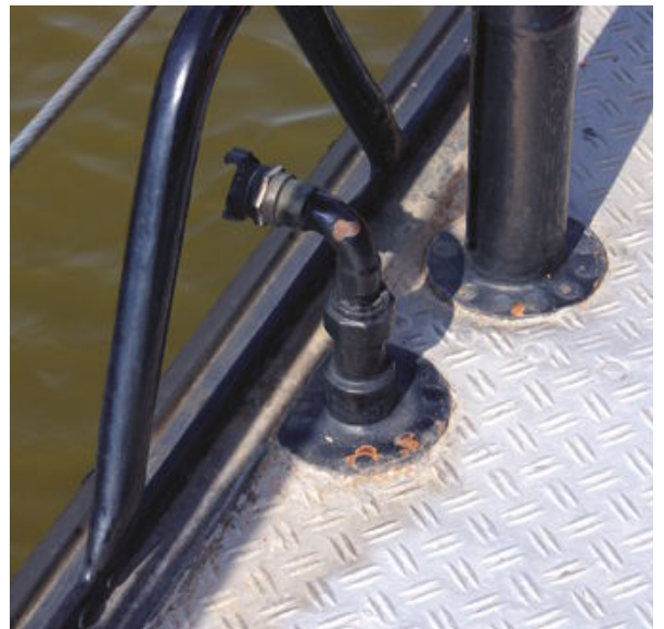
Ausgänge zur Erzeugung des Wassernebels
