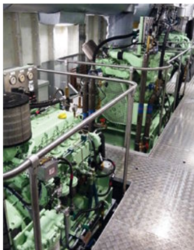
Der Maschinenraum. Im Vordergrund die Dieselgeneratoren
