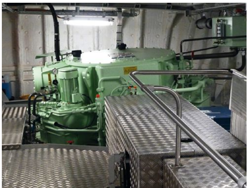
Einer der Voith-Schneider-Antriebe im Maschinenraum
