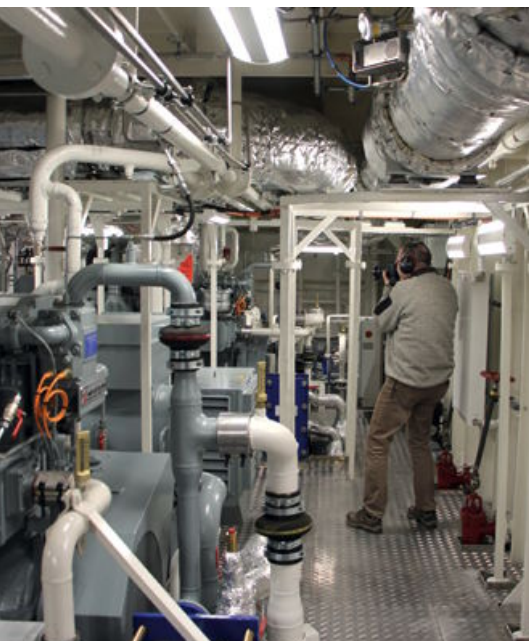
Besichtigung des Maschinenraums
