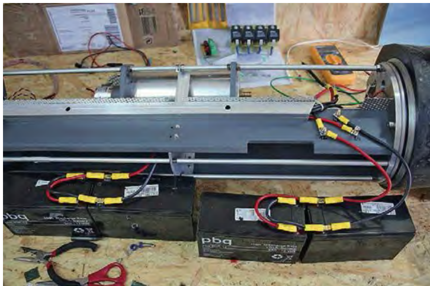
Im hinteren Technikgerüst sind auch die vier Akkus untergebracht
