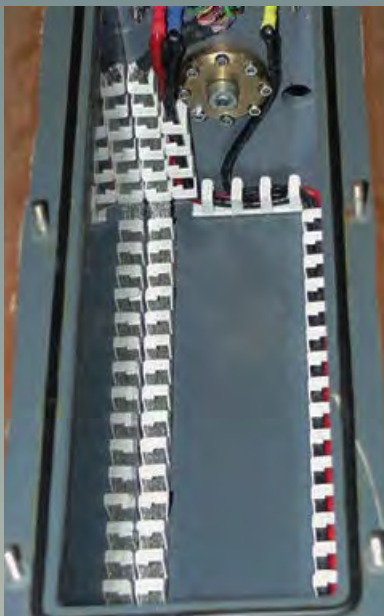
▲ Die später fertiggestellte Verkabelung im Ausfahrgerätekasten zum Verbinden der beiden Technikeinschübe
