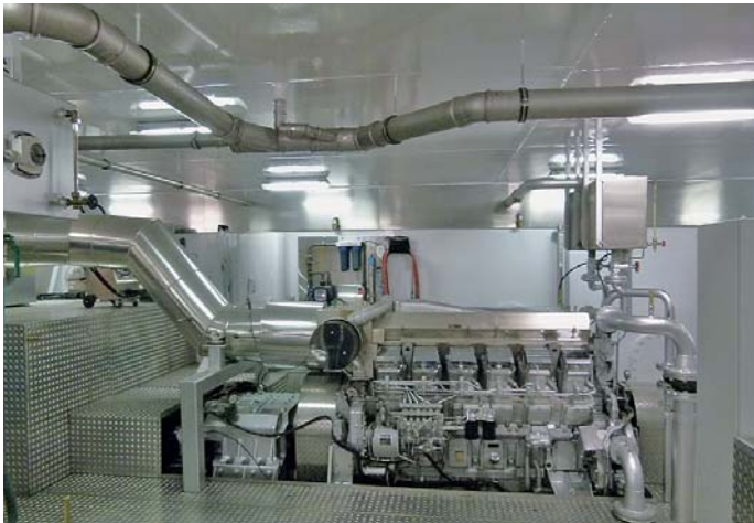
Blick in den Maschinenraum
